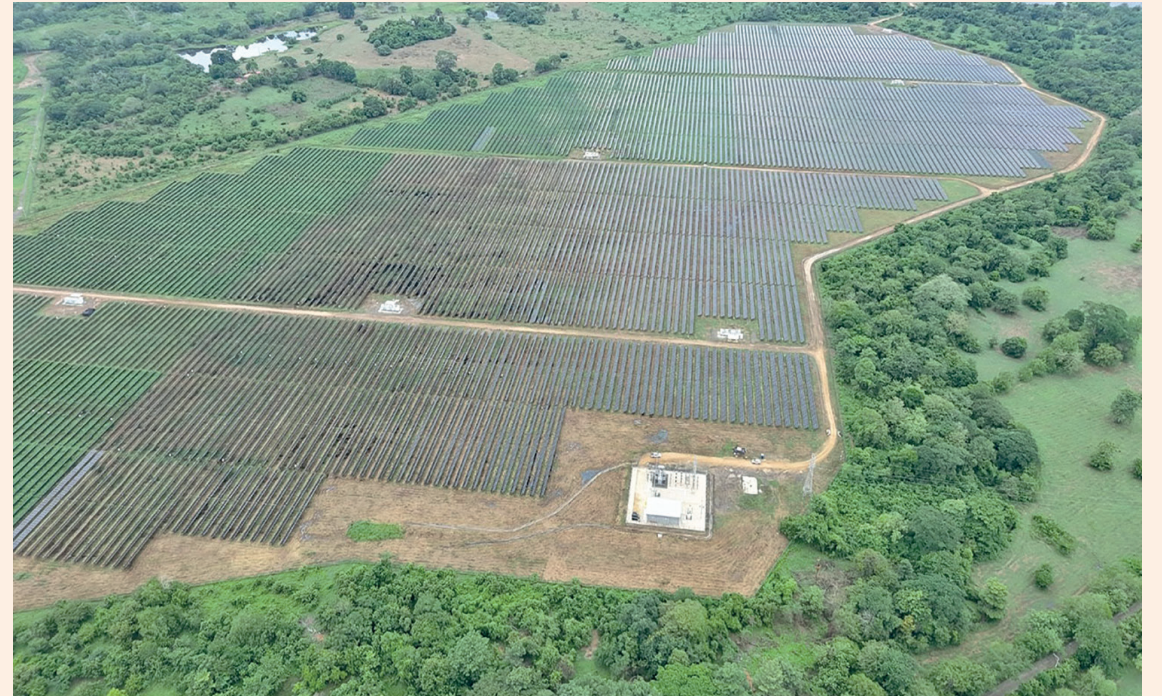
Foto: Ministerio de Minas y Energía
